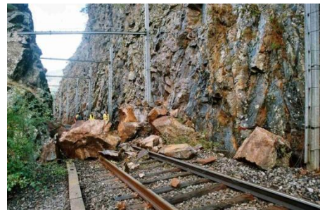
Figure 1 : Chute de blocs rocheux sur la voie ferrée
